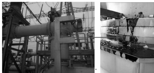
图 2 故障气室现场检查情况
